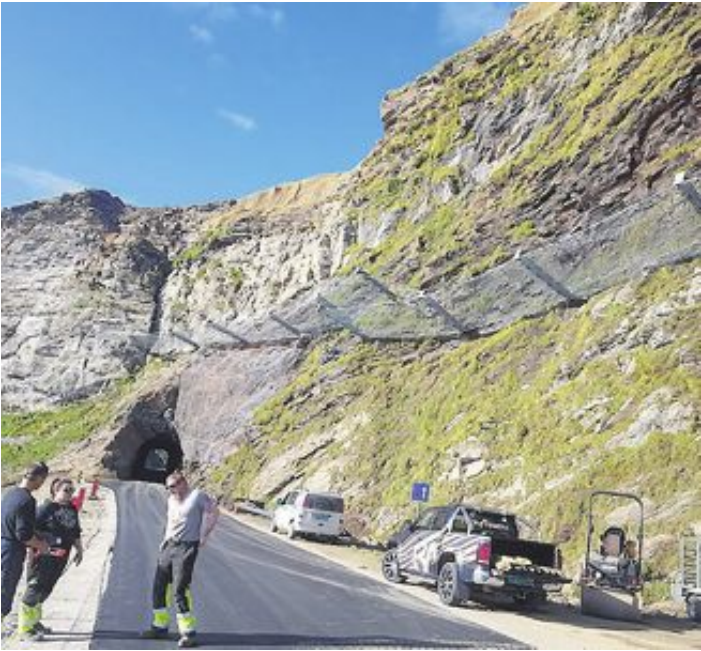
FALKENBERGTUNNELLEN: Like etter at entreprenøren var ferdig med den opprinnelige jobben like før jul i fjor, gikk steinraset som isolerte Sørvær, og entreprenøren måtte dermed starte på ny jobb på samme sted.
